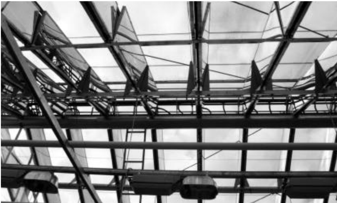
The PV façade.
